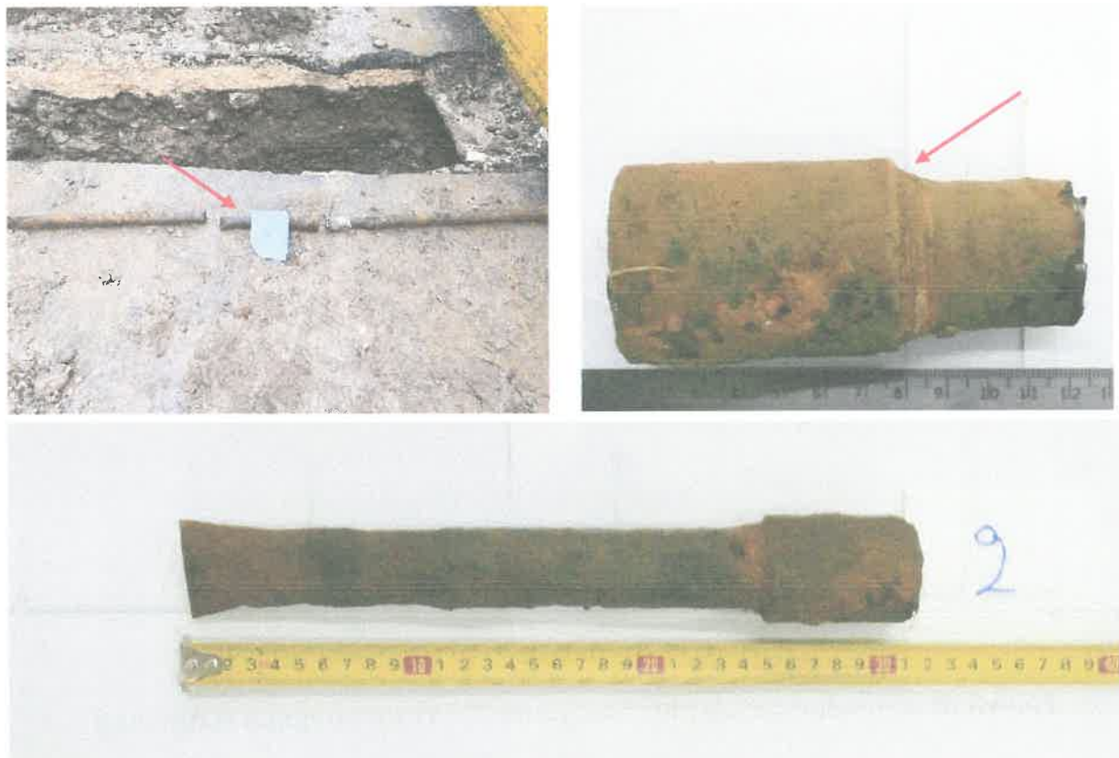
Εικόνα 11: “Δείγμα 2” από περιοχή βιδωτής σύνδεσης τμημάτων της σωλήνωσης
