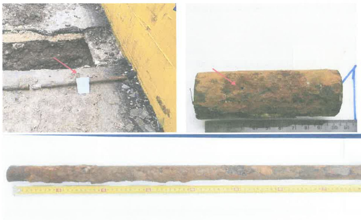
Εικόνα 13: “Δείγμα 1” από περιοχή διάτρησης στο υπόγειο τμήμα της σωλήνωσης
