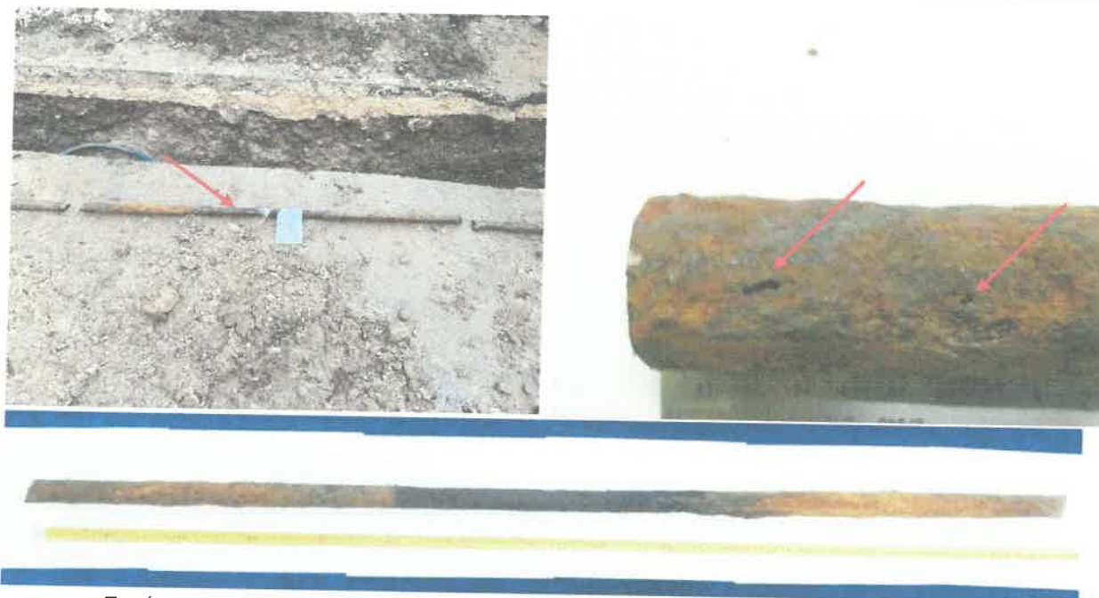
Εικόνα 14: “Δείγμα 3” από περιοχή διάτρησης στο υπόγειο τμήμα της σωλήνωσης
